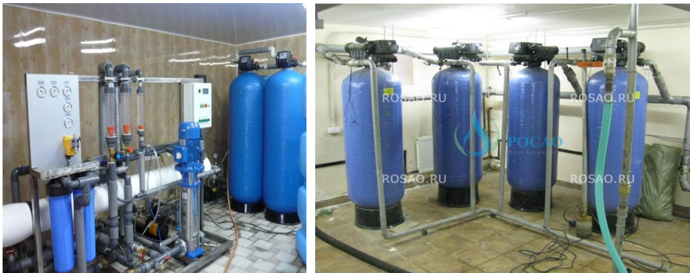
Рисунок 1. Системы очистки воды в подвале многоквартирного дома ТСЖ
