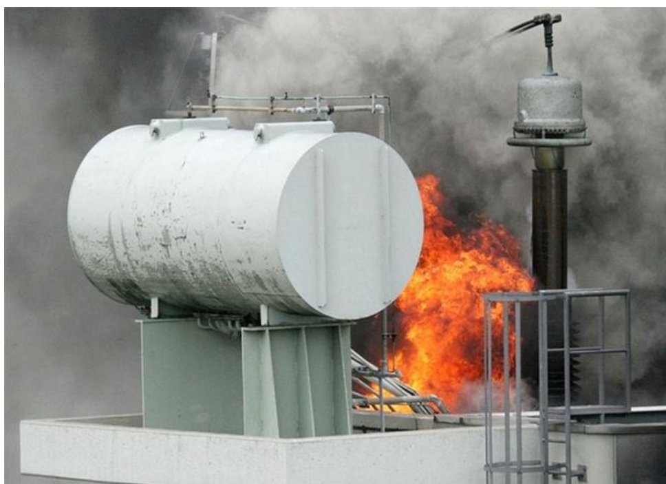
Рисунок 1. Воспламенение масляного автотрансформатора
