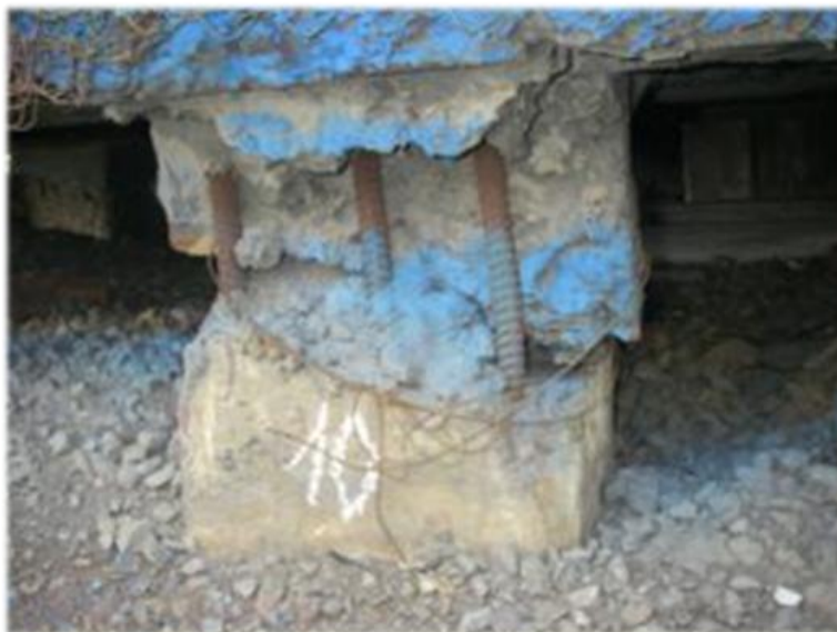
Рис. 5. Разрушение бетона свай с оголением арматуры
